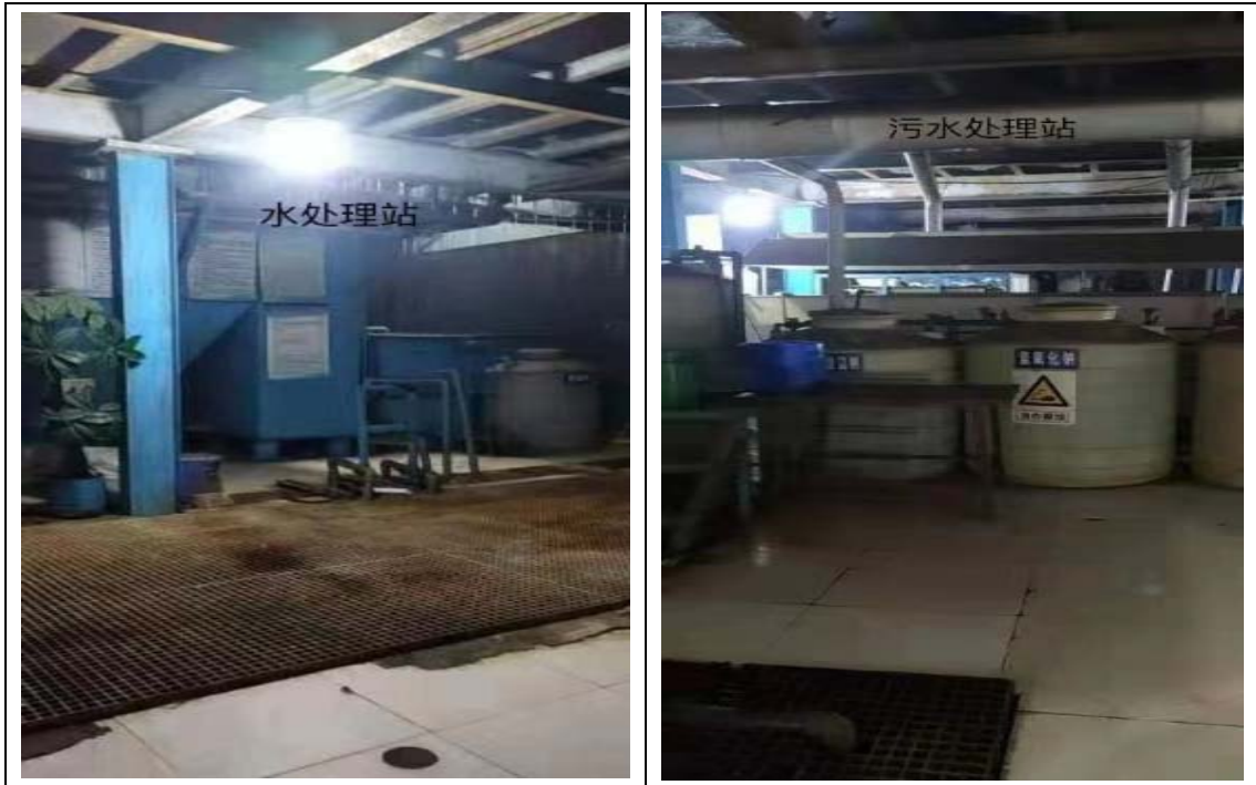
图3.3-1 车间内污水处理站
