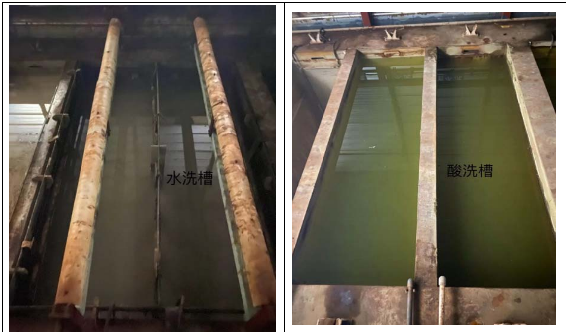
图 3.2-2 生产车间液体物料储槽
